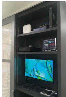
図③ デジタルデータ、通信関連を一括管理する PC エリア。最上段に通信、Wi-Fi、2 段目に Smart BGM 専用の iPad とアンプを設置
